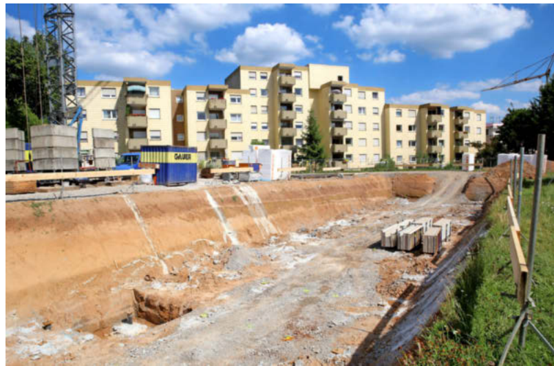
Dieses Frühjahr hat die Gewo in Bad Friedrichshall-Plattenwald mit dem Bau von 36 besonders günstigen Wohnungen begonnen.
